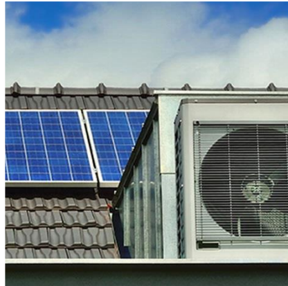
RCP et installations hybrides
